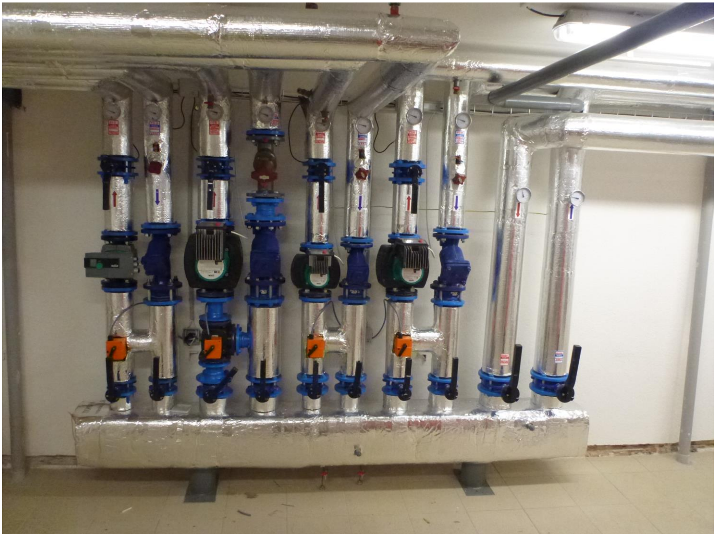
Kotelna po rekonstrukci.
